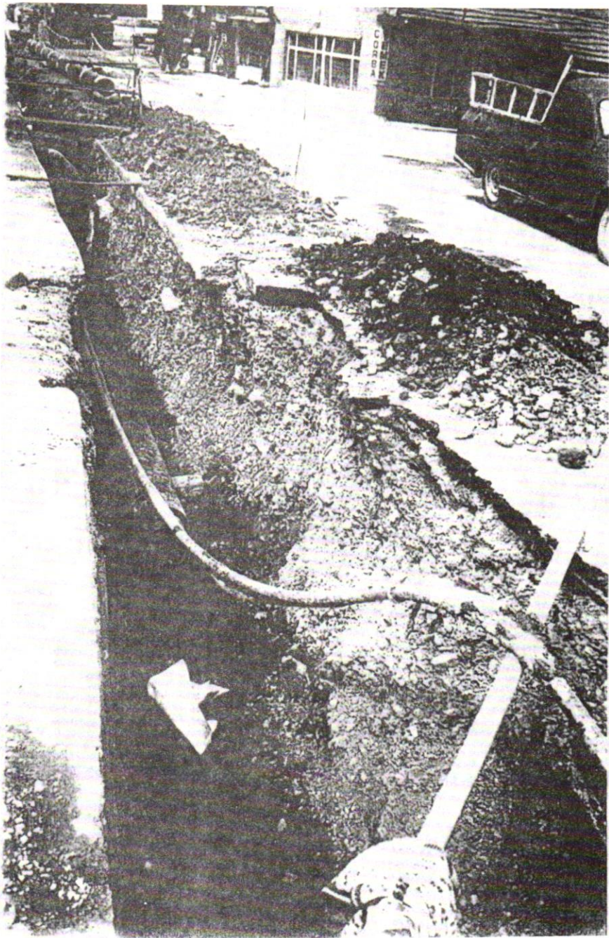
2.5. Doğalgaz nakil hatları ve yardımcı tesisleri. Kilit boru.
